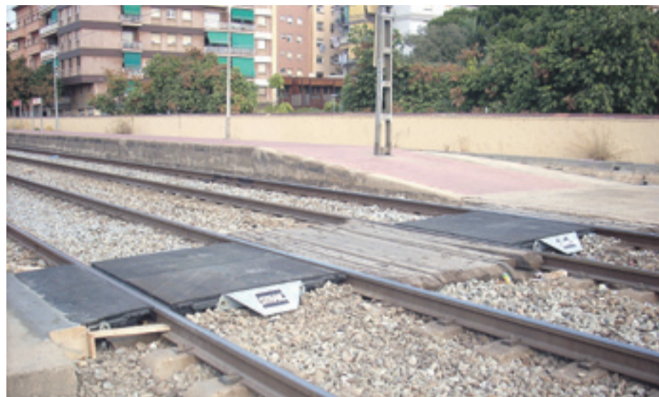
El paso a nivel de la estación de RENFE de Sant Feliu
