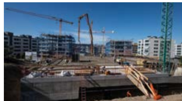
Les obres de construcció de l'equipament Soledat Sans a Mas Lluí-Sant Just avancen a bon ritme. L'estructura està pràcticament enllestida (a la imatge) i aviat es començarà a treballar en la resta de parts de l'obra.
